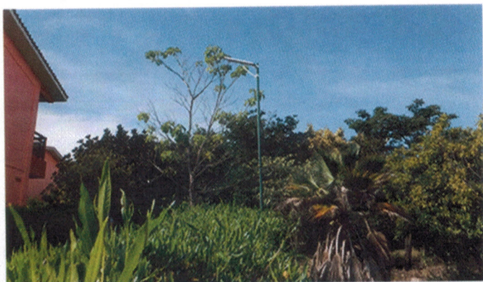
Luminarias hacia salas de computo y aulas
