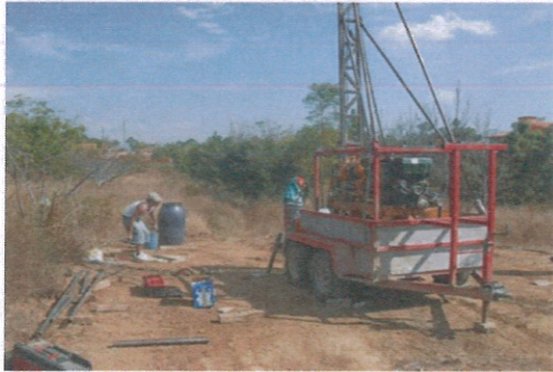
F1- Mecanica de Suelos para el Edificio
