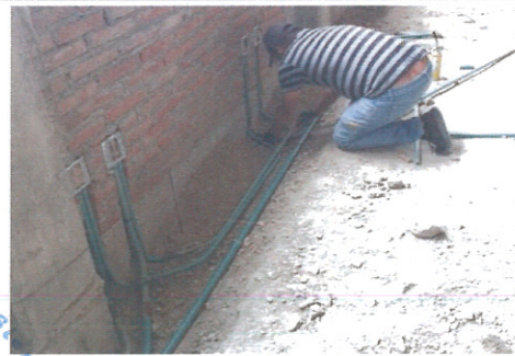
F4- Instalaciones Electricas CEDGE
