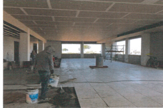
F2- Loseta y plafon en planta baja
