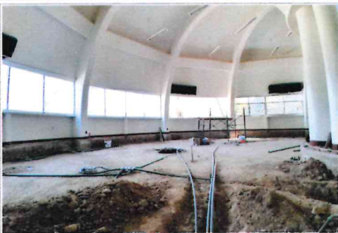
F3- Instalaciones electricas y de red en area de lectura
